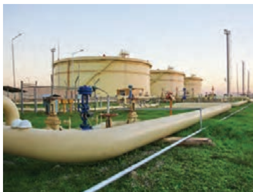
شکل ۲۲- نمایی از خطوط انتقال سوخت
