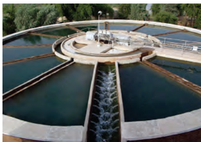
آب در تصفیه‌خانه
